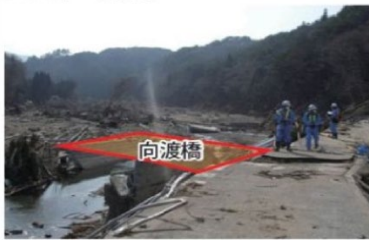
千鶏地区:道路崩落
