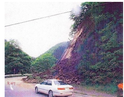
H15.5.26 南三陸地震による法面崩壊
