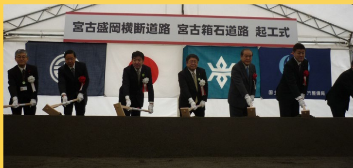
▲ 一日も早い完成と工事の安全を祈念して、山本正徳宮古市長はじめ、来賓の方々や関係者による“鍬入れ”が行われました
