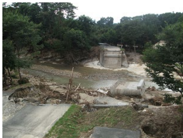
一般県道紫波雫石線：矢櫃橋(雫石町)の上部工、橋脚流失箇所
