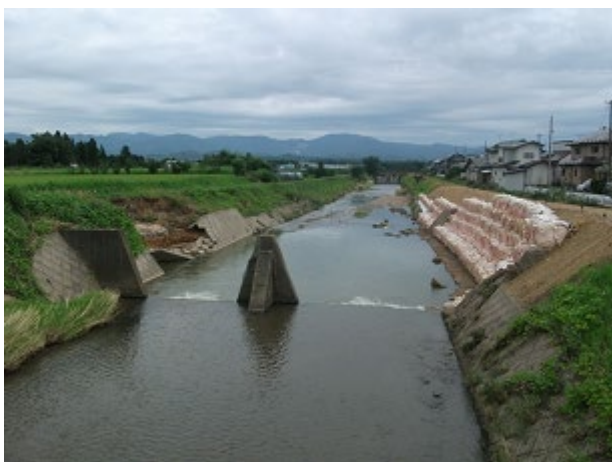
太田川(紫波町中島地区)：堤防決壊箇所。応急工事了。
