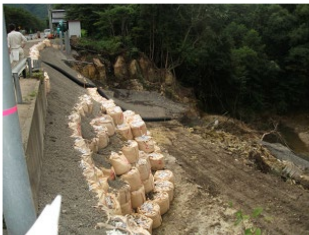
一般県道鶯宿温泉線：雫石町南畑小学校前の法面崩落箇所。応急工事を行い、片側交互通行実施中。
