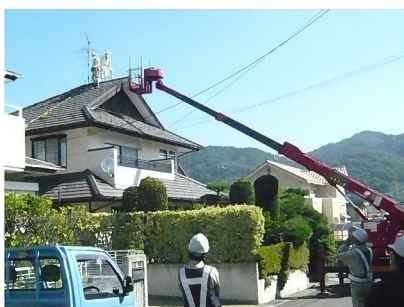
屋根の表面線量の測定状況 線量を測定しながらの除染が続きます
