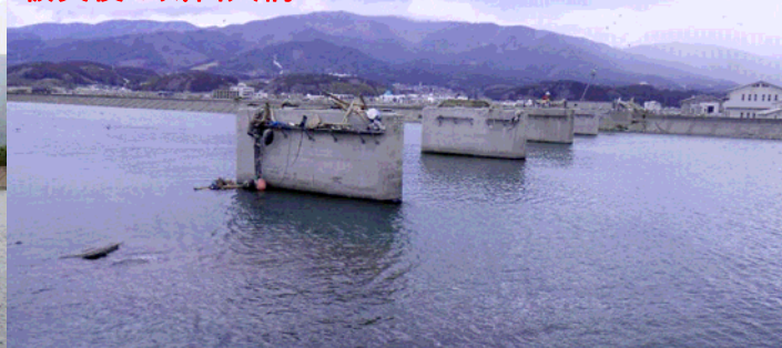
被災後の気仙大橋
