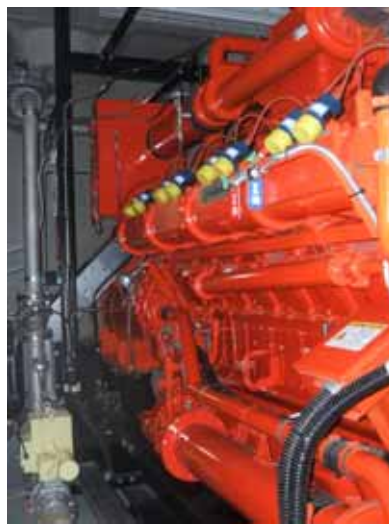
消化ガスエンジン (V型 16気筒)
