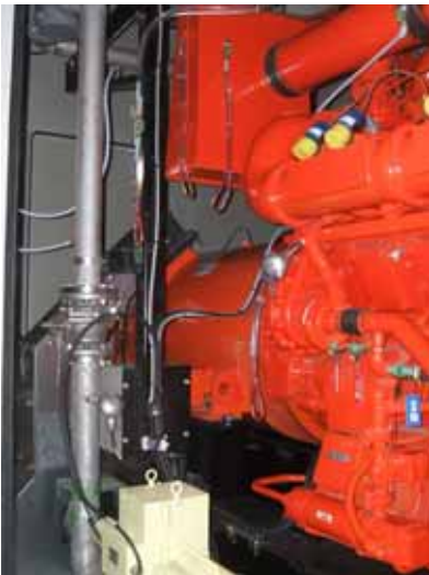
発電機 (奥の円筒形部分)
