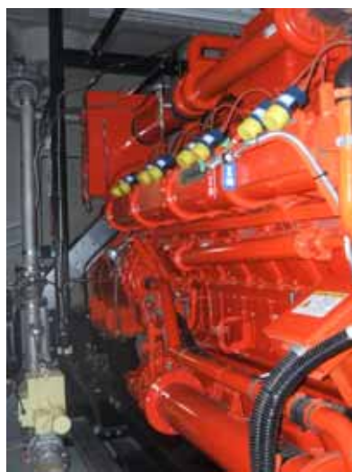
消化ガスエンジン (V型16気筒)
