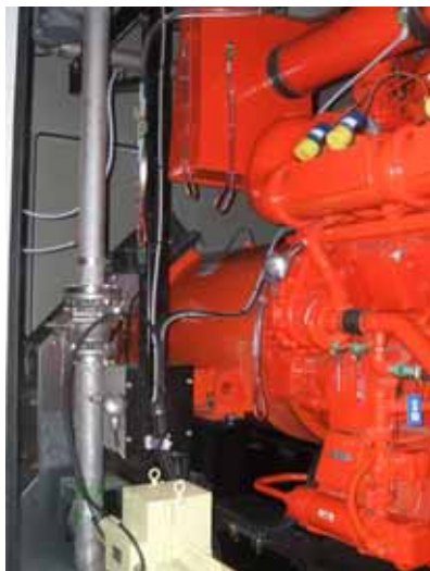
発電機 (奥の円筒形部分)
