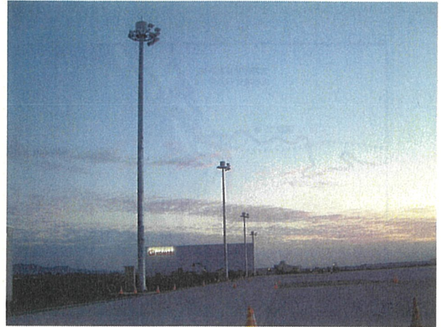
新設エプロン照明灯柱
