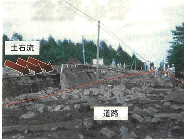
写真6 御神坂沢の土石流発生時の状況
