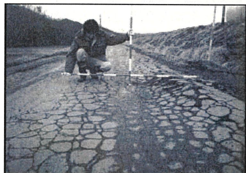
舗装面の盛り上がり、沈下
