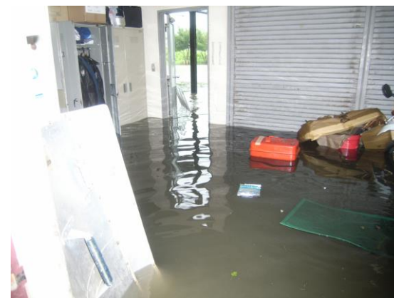
交通機動隊 庁舎 1階 浸水状況 H25年 8月
