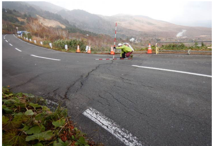
路面上に地すべりが起因したクラック発生状況
