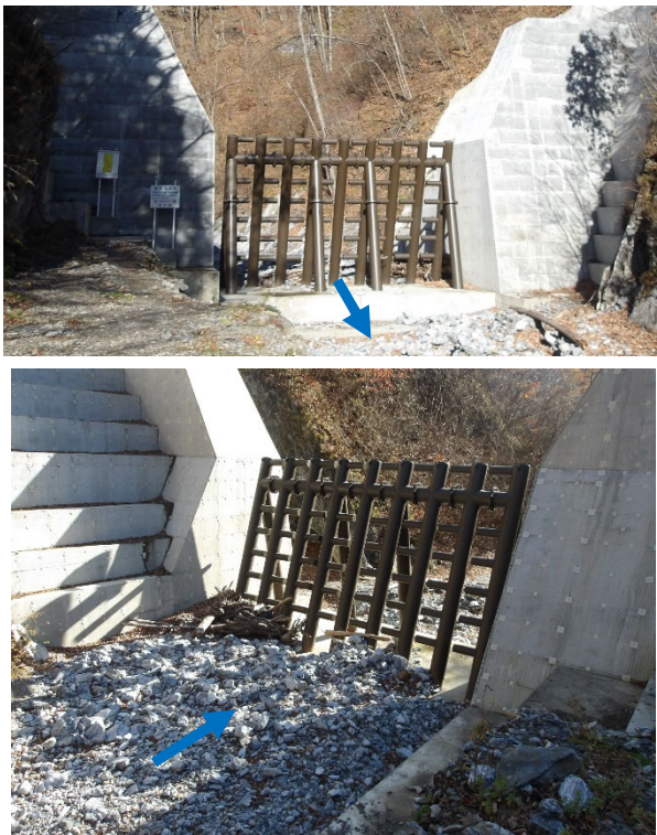
土石流発生前(R5年11月撮影)
