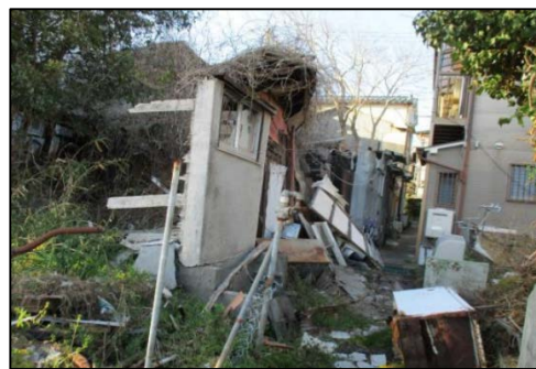
瓦礫が放置され、雑草の繁茂や不法投棄も発生している管理不全状態の土地
