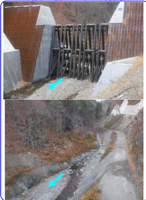
土石流発生前(R4年11月撮影)
