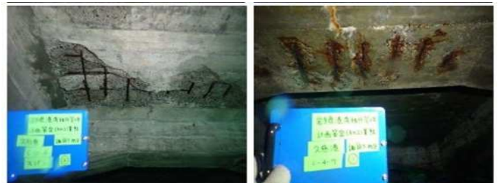
港湾施設の損傷事例
