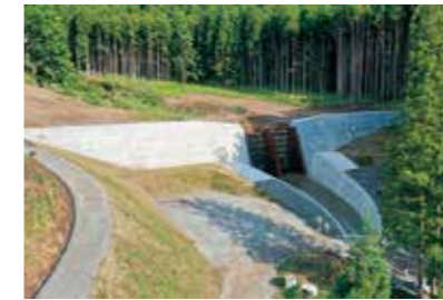
砂防激甚災害対策特別緊急事業の完了
