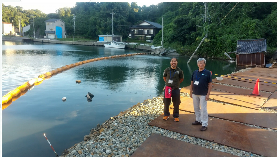
能登町道小木志ノ瀬1号線 …海に面した道路が崩落。令和6年奥能登豪雨により二重被災
