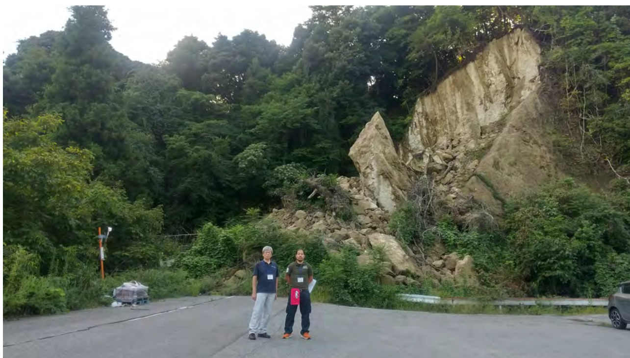
能登町道1級宇出津8号線 …トンネル坑口上の斜面が崩落し通行止め
