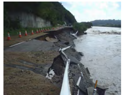
国道106号の被害状況（宮古市）
