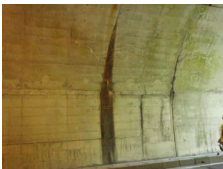
漏水発生状況
