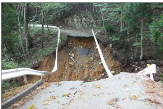
主要地方道重茂半島線の崩落（宮古市川代）
