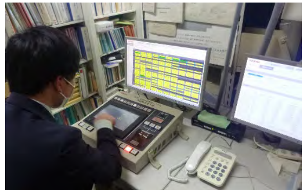
岩手県庁（第1統制局）での動作確認状況
