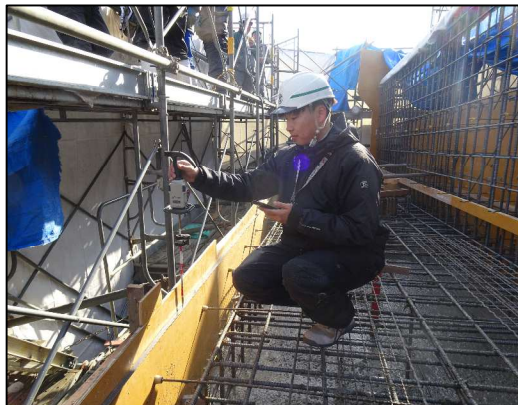
（写真左）橋梁下部工工事の現場で測量をしている様子です！
