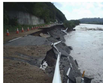
国道106号の被害状況（宮古市）
