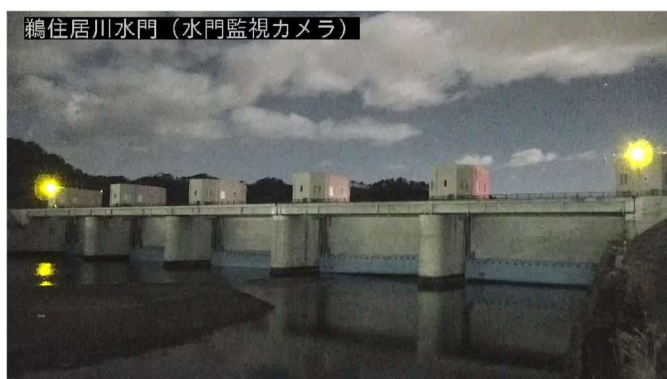
鵜住居川水門の閉鎖状況（R7.12月 釜石市）
