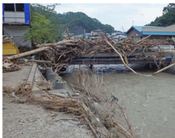
小本川流域の被害状況（岩泉町）
