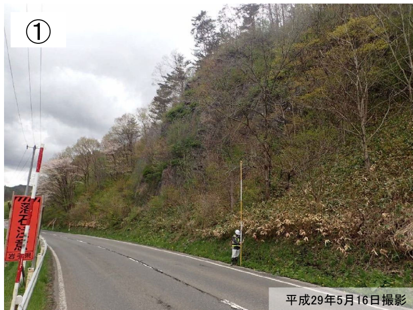
【現道課題】防災点検要対策箇所
