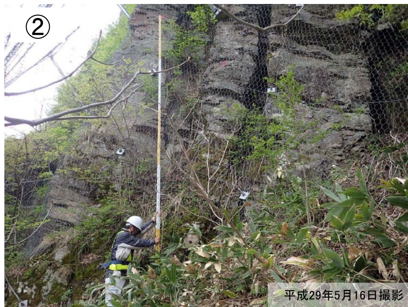
【現道課題】露出岩状況
