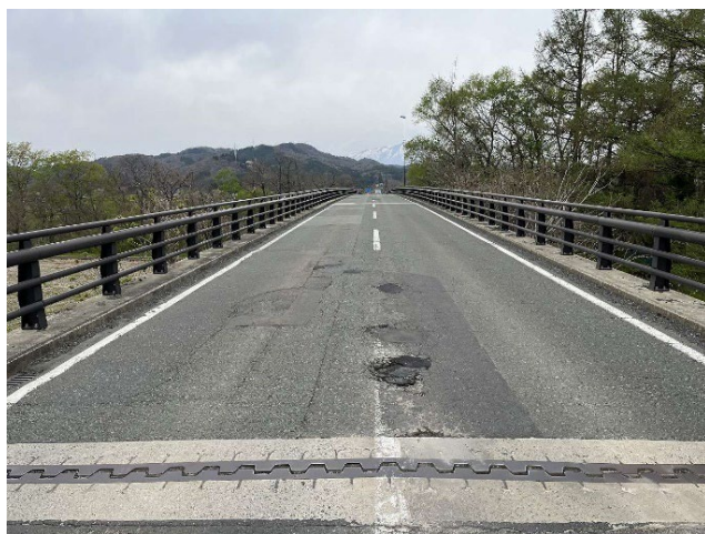
橋面（床版の劣化に伴う舗装の損傷）
